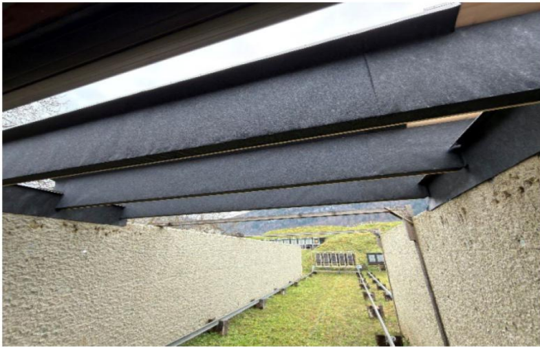
Scheiben 1-5; Lärmschutzwände links und rechts; Lärmschutzlamellen oben
